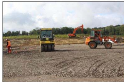
Les travaux de la future déchetterie intercommunale ont démarré mi-août sur un terrain de plus d'un hectare, au bout de la zone d'activités de Retzwiller. Archives L'Alsace/Vivian MILLET
